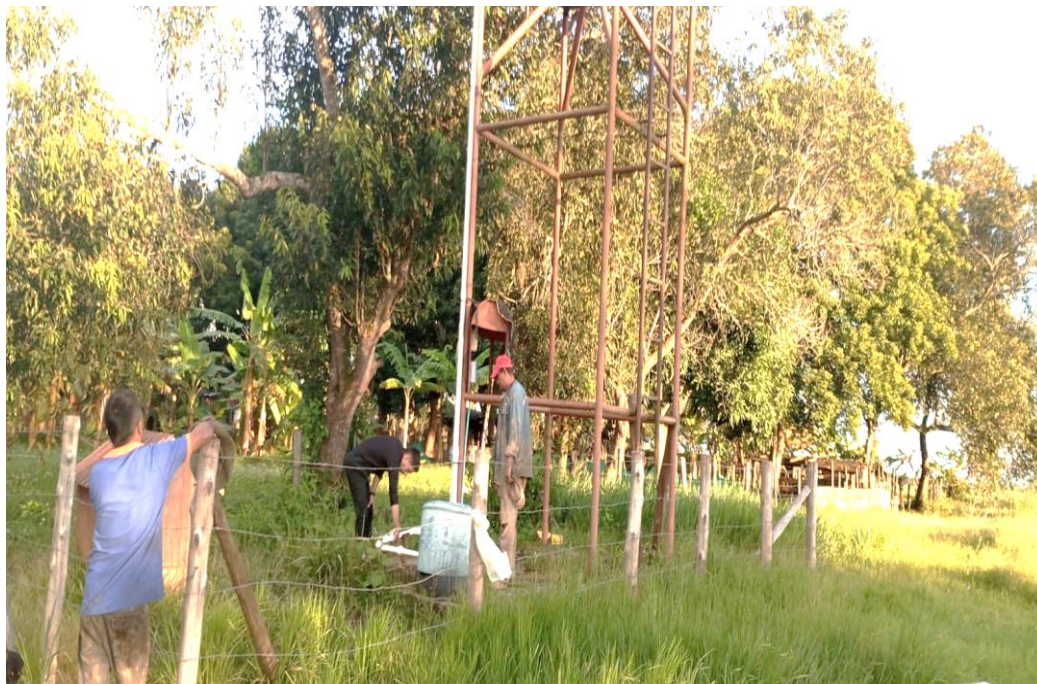
Fotografía No. 18. Identificación de fugas en un sistema de captación, específicamente en la conexión de los codos, válvulas de control y regulación – todos los sistemas de captación y conducción en el predio Los Ripios se encuentran en buenas condiciones para su funcionamiento.
