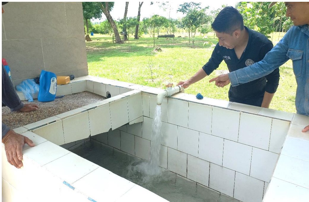
Fotografía No. 18. Identificación de fugas en un sistema de distribución, específicamente en la conexión del codo previo a la válvula de control y regulación – se efectuó la respectiva recomendación para el ajuste, reparación y como desarrollar el proceso.
